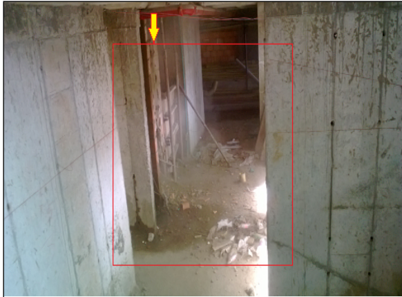
Figura 11. Material particulado proveniente de conductos donde se arrojan los escombros
