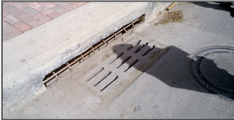
Figura 7. Sumidero en la parte baja de la pendiente de la vía de acceso a la obra.
